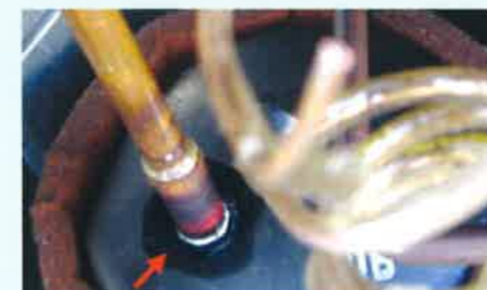
油漏れやしみで漏えいを確認
