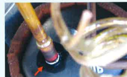
油漏れやしみで漏えいを確認
